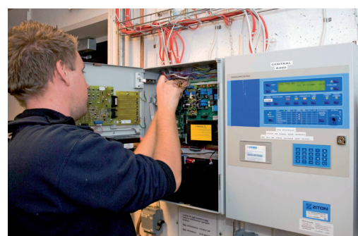
Nedan: Inkoppling av centralapparat.
